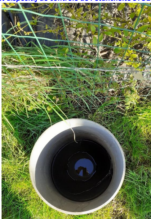
Figure 9: dispositif de contrôle de l'étanchéité de la fosse extérieure STO2
